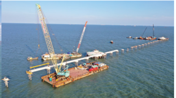
Installation of prestressed precast girder of link bridge Công tác lắp dầm
