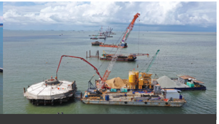
Casting concrete for wind turbine foundation Đổ bê tông móng trụ gió
